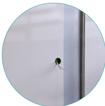
Открытая установная панель и провода
