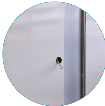
Открытая установная панель и провода
