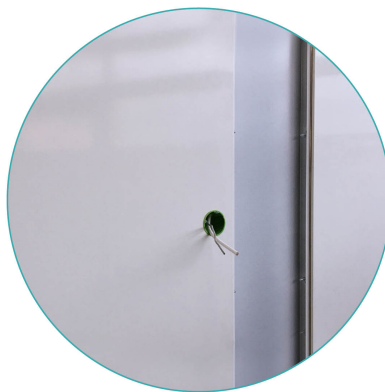
Odkrytý inštalačný stĺpik a elektroinštalácia
